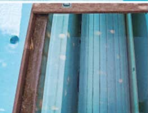
Die Holzdielen an der Stirnseite des Beckens können hochgeklappt werden. Dies ermöglicht einen direkten Zugriff auf den Rollladenschacht.
